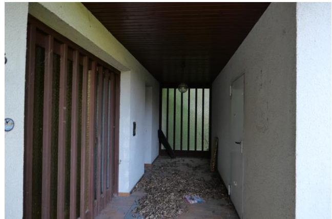
Abbildung 22: Kotpellets an der Hausmauer weisen auf genutzte Quartiere hinter den Fensterläden hin.
